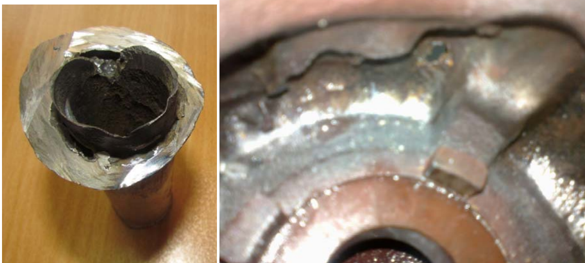
نمونه ای از قطعات خورده شده در مسیر آب کندانس
