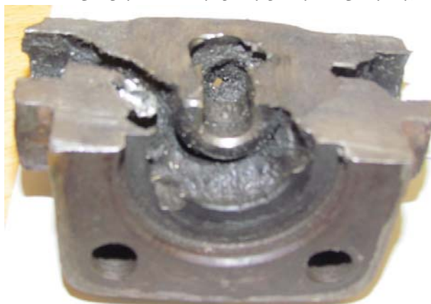
شکل ۱: حفره‌های عمیق در مسیر آب کندانس
